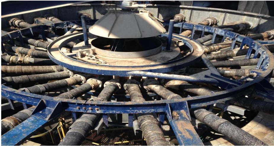
Figure 8 : vue des capillaires
