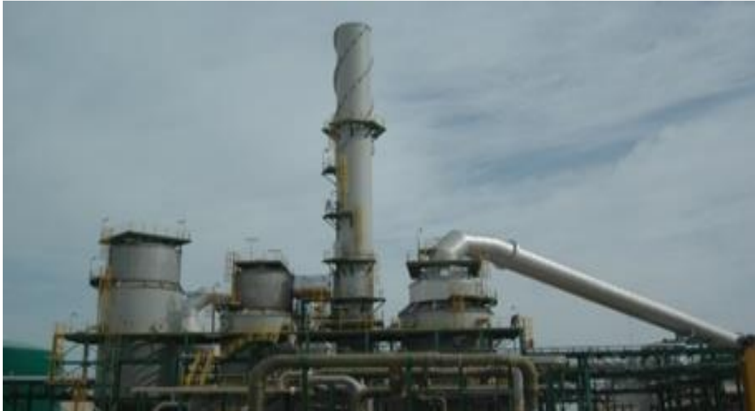
Figure 4: Vue de l'atelier sulfurique
