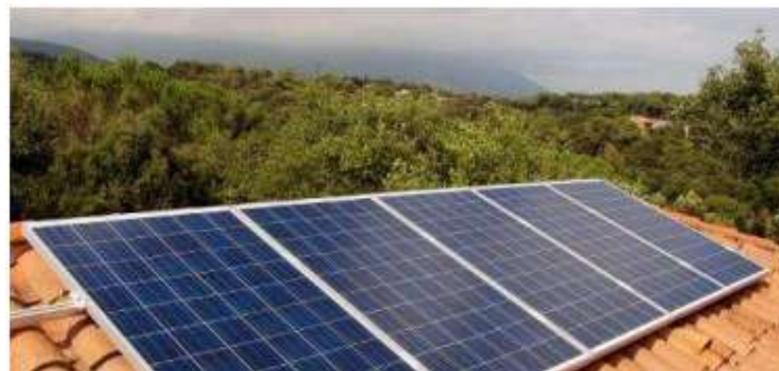
Figure 7: Exemple d'installation domestique de panneaux photovoltaïques
