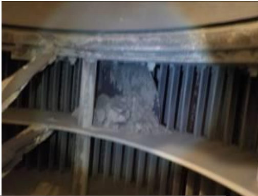
Figure 31-6 : Présence de ferrailles dans la cage (Ils sont dégagés)
