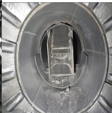
Figure 33-7 : La glisse d'alimentation RAS
