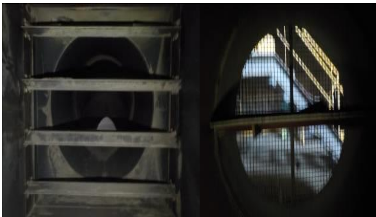
Figure 31-10 : Registre de recirculation RAS
