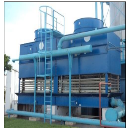
Figure 7: Tours de refroidissement
