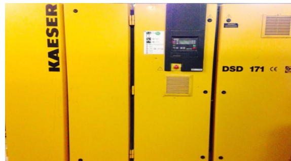
Figure 15 : Compresseur KAESER DSD 171
