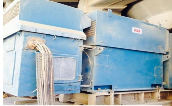
Figure 11: Moteur du broyeur
