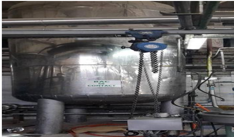
Figure 7 : Bac de contact
