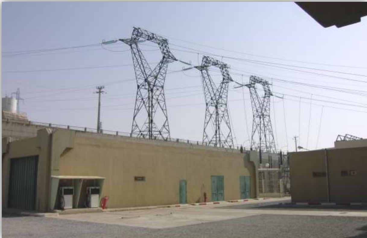
Figure 2.2 :les départs électriques
