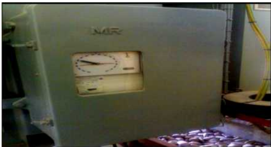
Figure 14 : Régulateur de tension.
