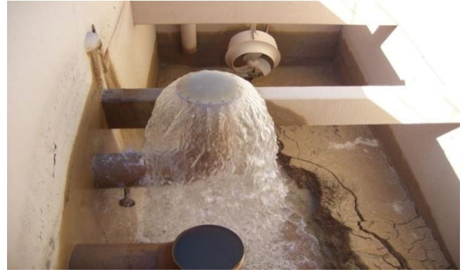
Figure 7 : la bâche de mélange des boues.
