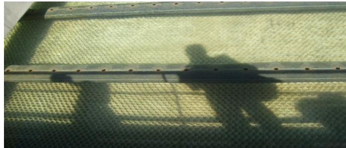
Figure 10 : Décanteur lamellaire en plastiques.
