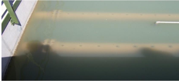
Figure 9 : Décanteur à canaux creusés.
