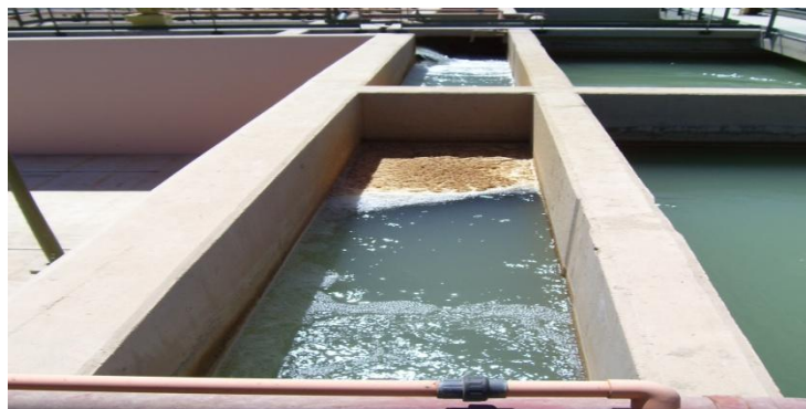
Figure 8 : bâche de flocculation
