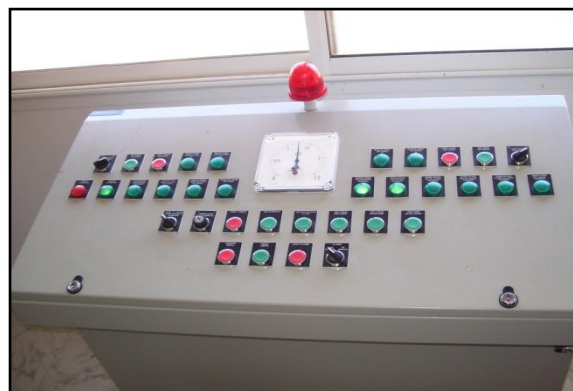
Figure 12 : Tableau de commande.
