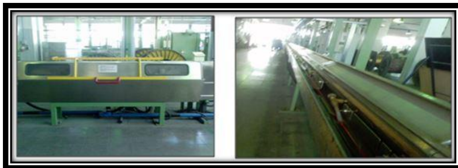
Figure 12 : Un bac et d'un accumulateur
