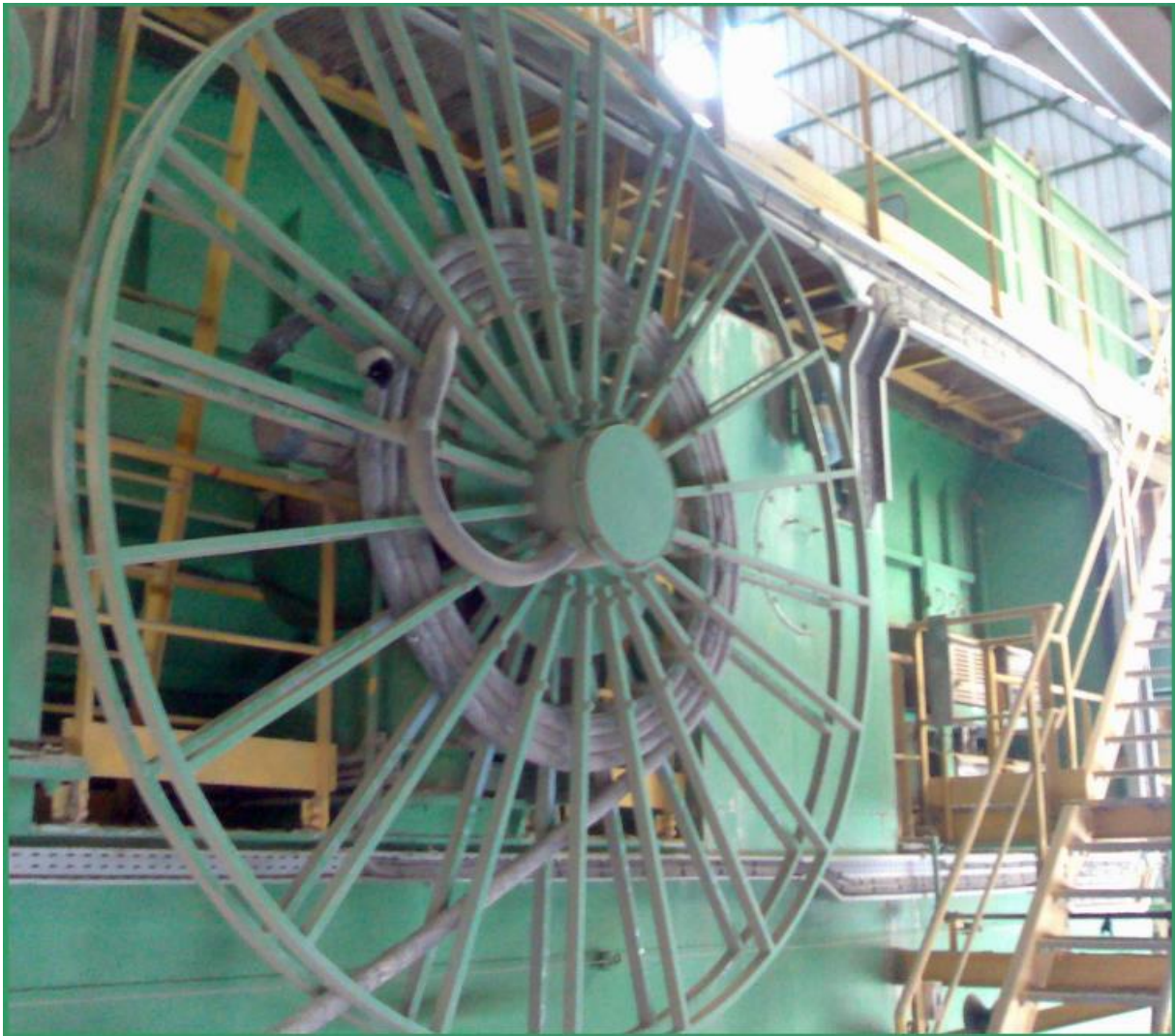
Figure II.4 : Vue sur l'enrouleur du câble du gratteur
