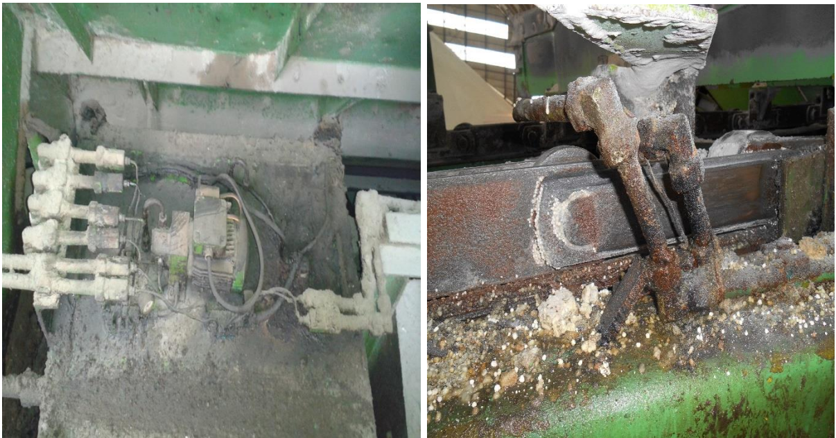
Figure III.6 : Vue sur l'ensemble de lubrification
