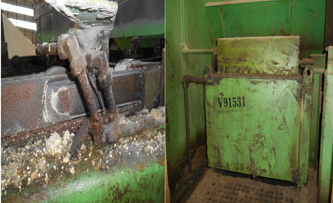
Figure II.9 : Vue sur l'ensemble de lubrification
