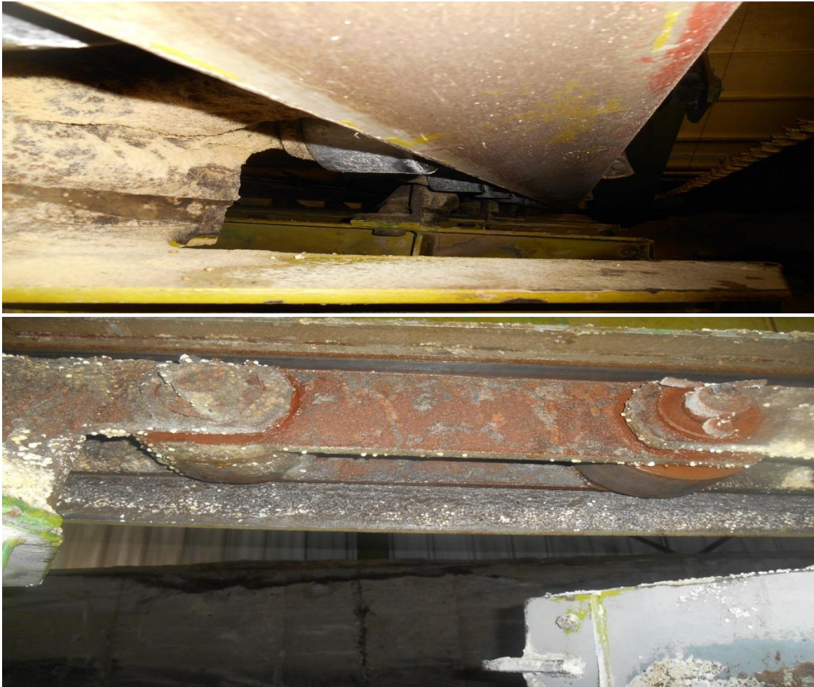
Figure III.9 : Vue sur les matériaux dégradés des glissières
