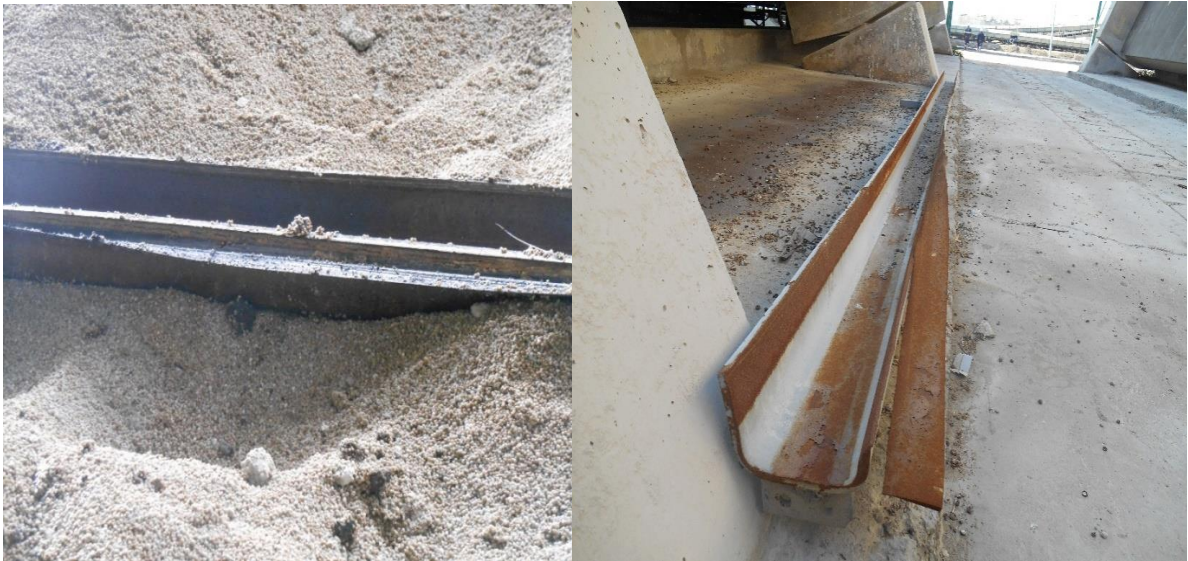
Figure III.4 : Vue sur des glissières dégradées
