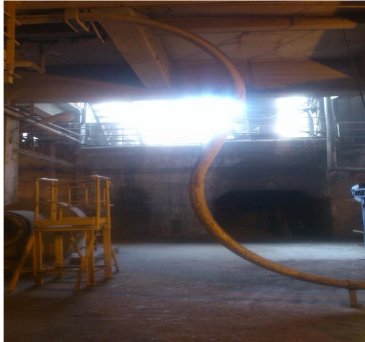
Figure 1-10: Partie de la ligne de conduite
