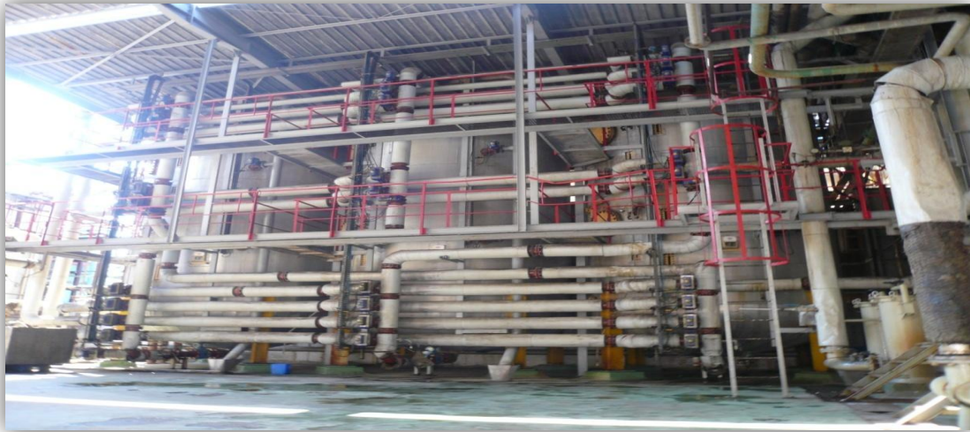
Figure 5 : Image des trois colonnes de la station 110 m 3 /h.
