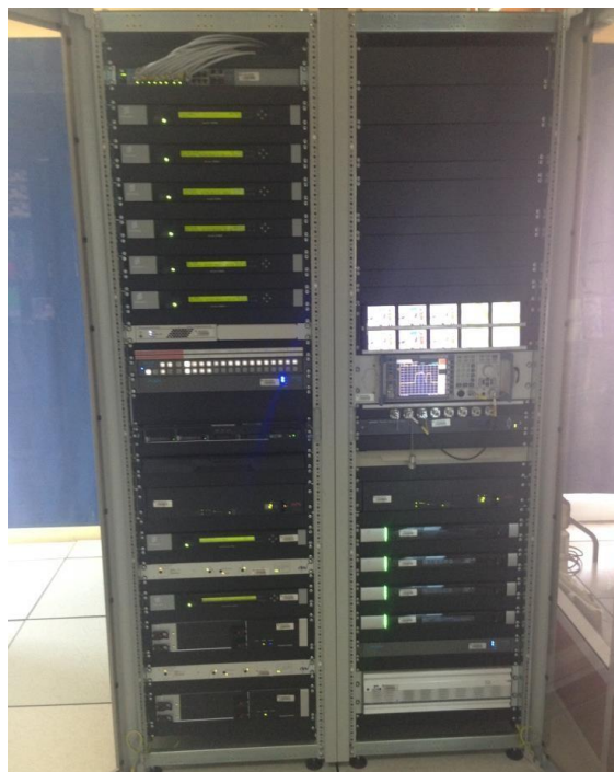
Figure 7 : Baie d'émission et baie de réception MCPC
