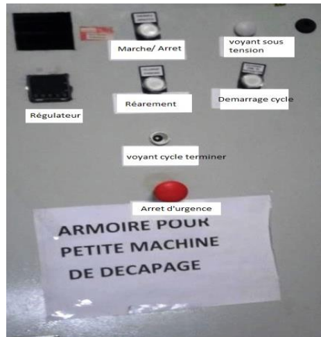
Figure 11: la forme du pupitre de commande de la gestion de démarrage
