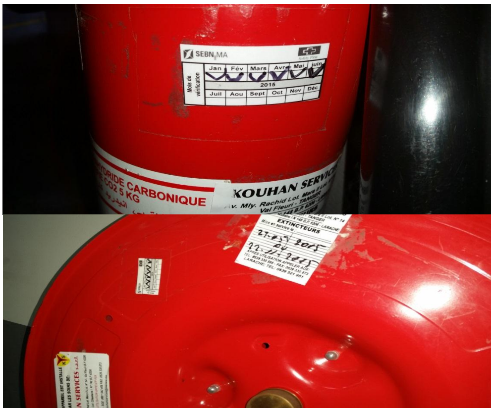
Figure 17 Ticket de validation des extincteurs et RIA
