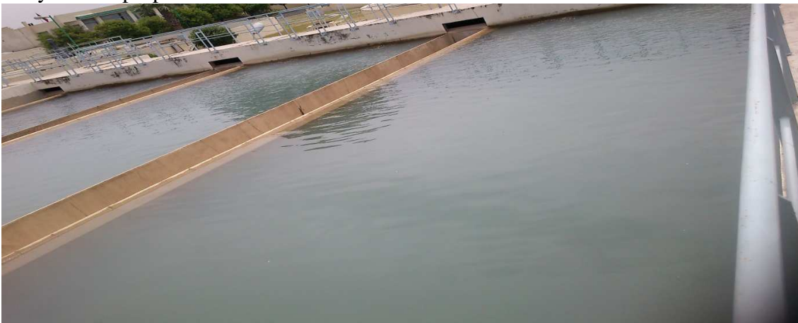
Figure 8 : les filtres à sables
