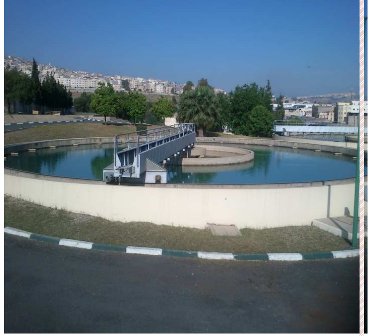
Figure 7. b : nouveau décanteur
