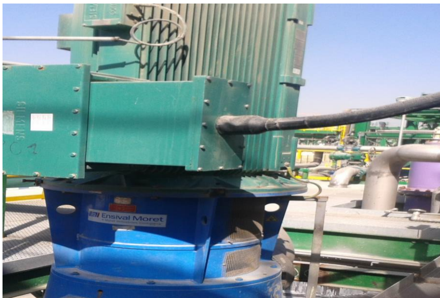
Figure 24: La partie supérieure de la pompe immergée dans le bac commun d'acide
