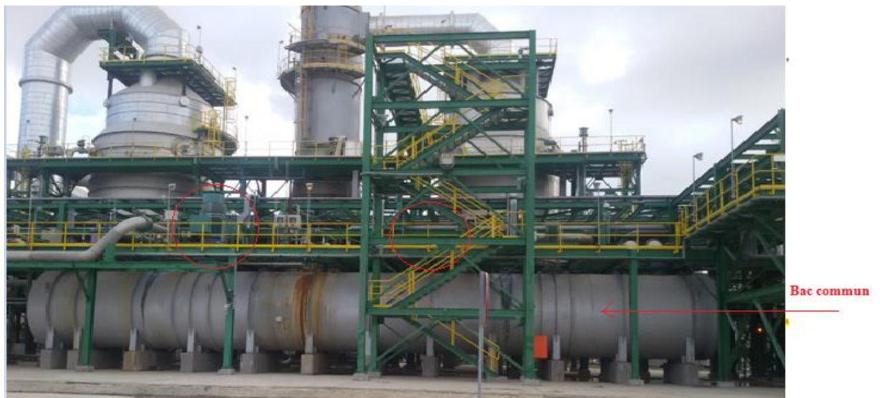
Figure 19: Vue réelle du bac commun d'acide et des deux pompes d'acide
