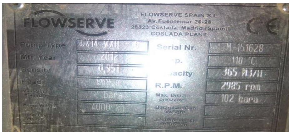
Figure 25: Fiche signalétique de la pompe de circulation d'acide
