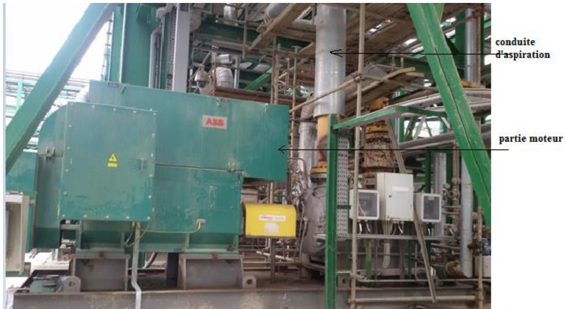
Figure 26: La pompe HP d'eau d'alimentation de la chaudière
