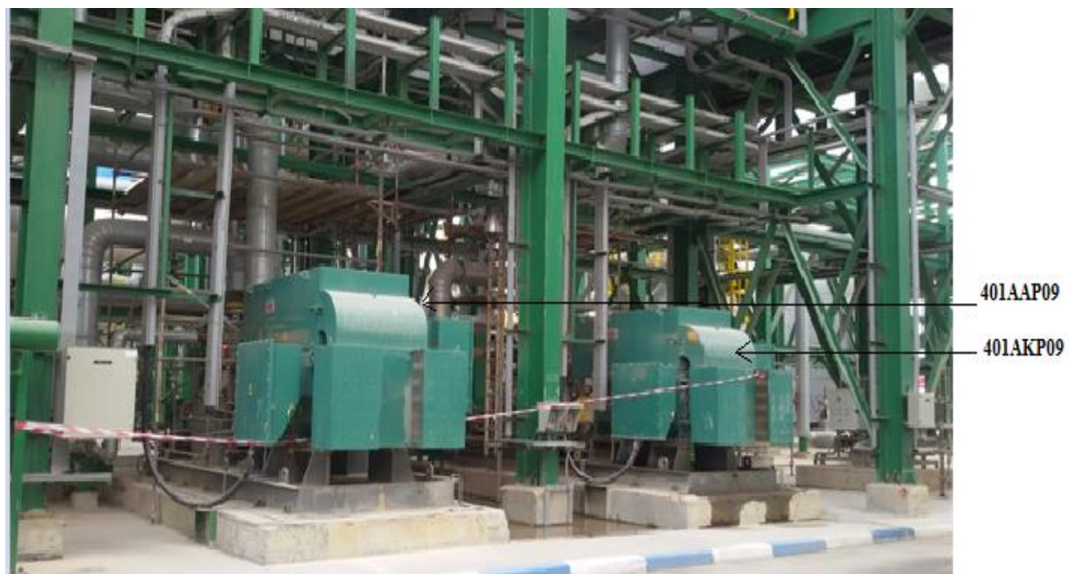
Figure 21: Vue réelle des deux pompes AAP09 et AKP09
