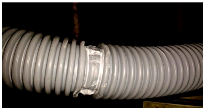
Figure 45: Conséquence d'une bride trop serrée
