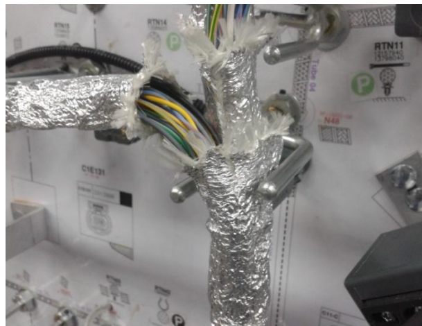
Figure 27: Tubes d'aluminium endommagés
