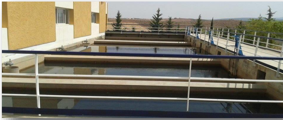
Figure 5 : Filtres à sable
