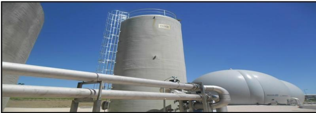
Figure 14: Photo d'un désulfure de biogaz STEP Fès
