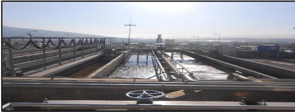
Figure 5: Photo d'un dessaleurs/déshuileur STEP Fès
