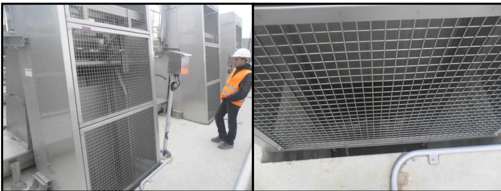
Figure 4: Photo d'un dégrillage fin STEP Fès
