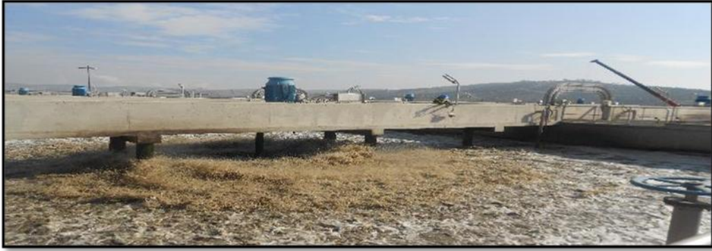
Figure 7: Photos du bassin d'aération STEP Fès
