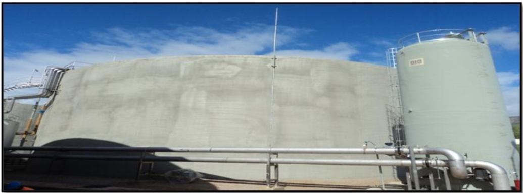
Figure 10: digesteur STEP Fès
