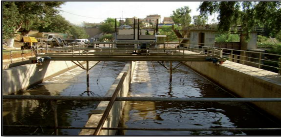
Figure 16: Photo de la station de prétraitement Zenjfour
