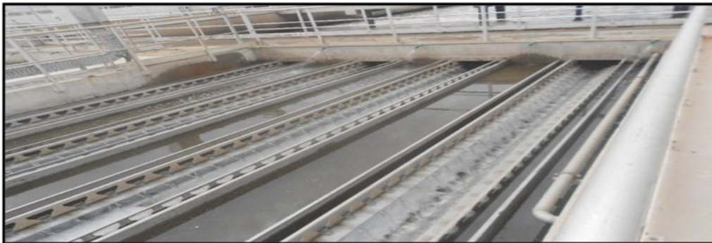
Figure 6: bassin de décantation primaire STEP Fès
