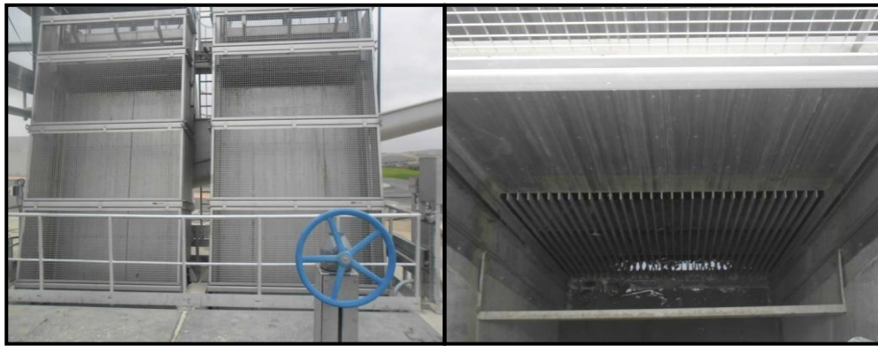
Figure 3: Photo d'un dégrillage grossier STEP Fès
