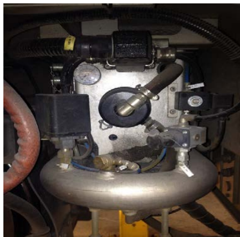
Figure 13: Compresseur de sablage
