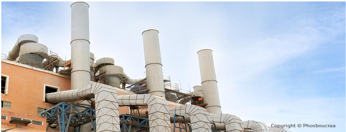
Figure 5 : Usine de traitement du minéral.
