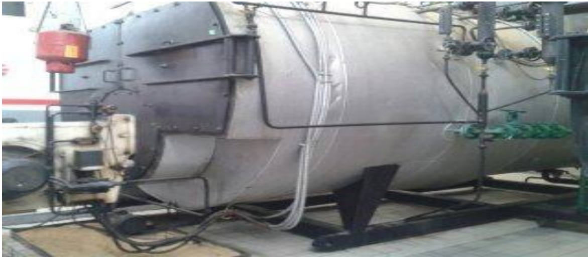
Figure 2.1 : Image de la chaudière à Fuel
