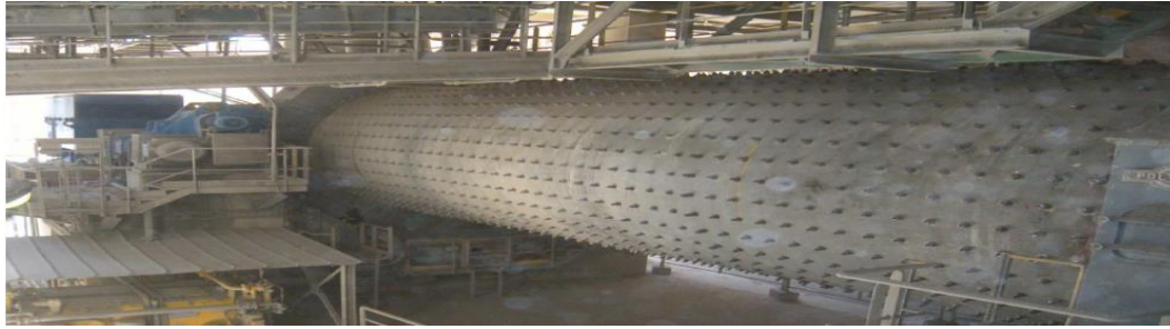
Figure 23: broyeur à boulets
