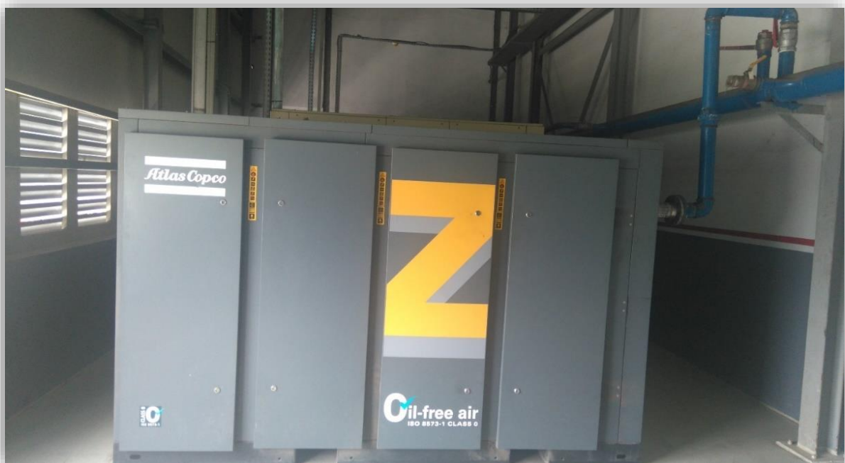
Figure 14 : Compresseur ATLAS COPCO(132KW)
