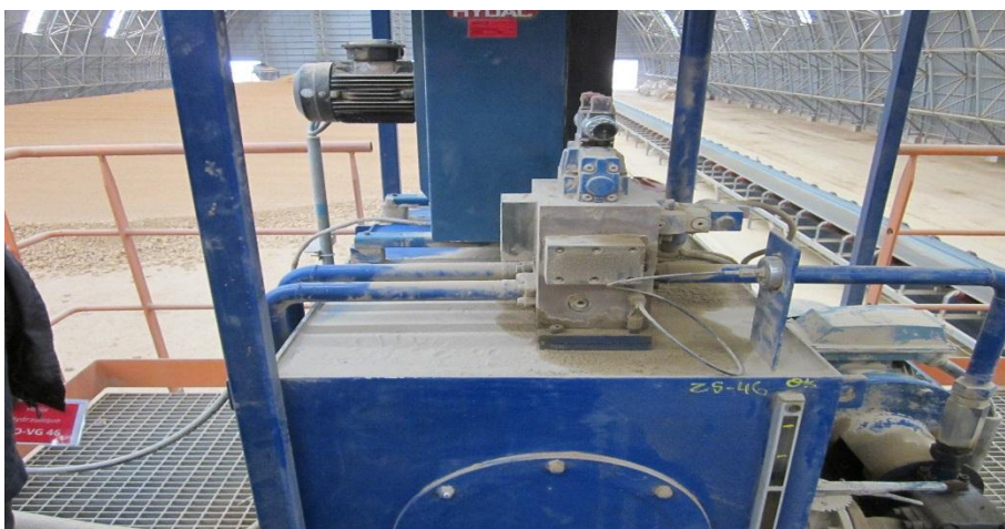
Figure 31 : centrale hydraulique - GRATTEUR
