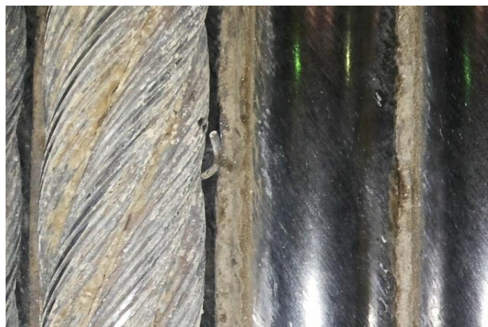
Figure 58 : La casse des brins apparait proche de la chape
