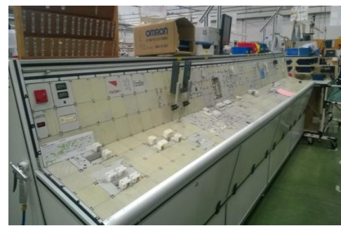
Figure 15 : Poste test électrique
