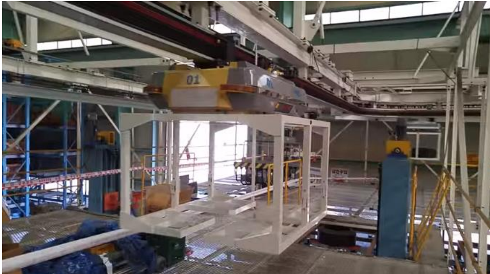
Figure 25: Chariot motorisé d'un monorail électrique
