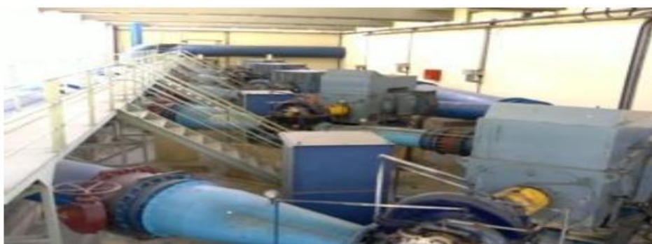
Figure 7 : Station de pompage d'eau brute
