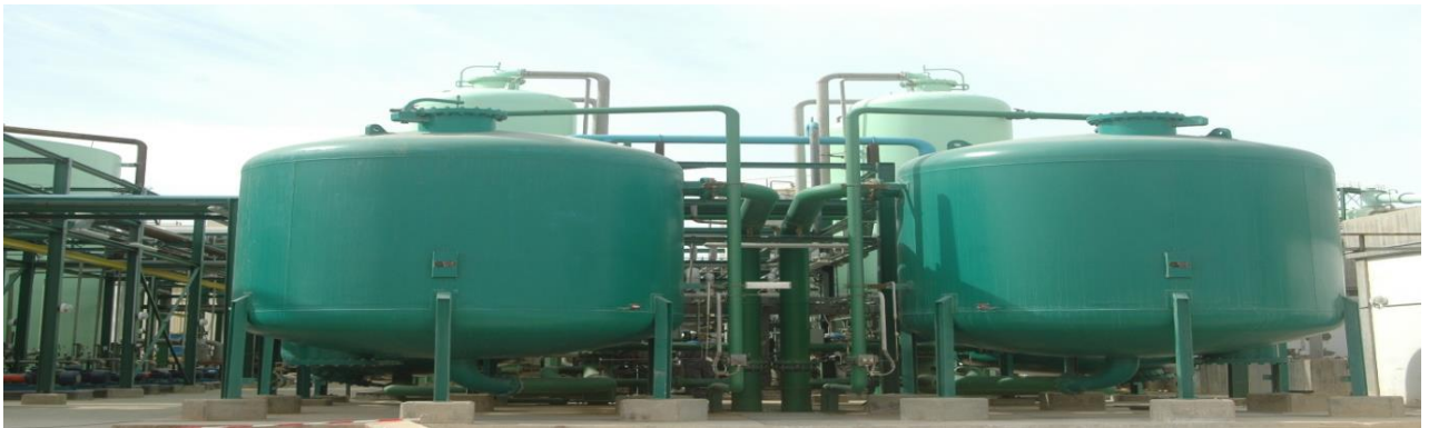
Figure 6: Vue de la station de traitement des eaux douces (unité de déminéralisation)
