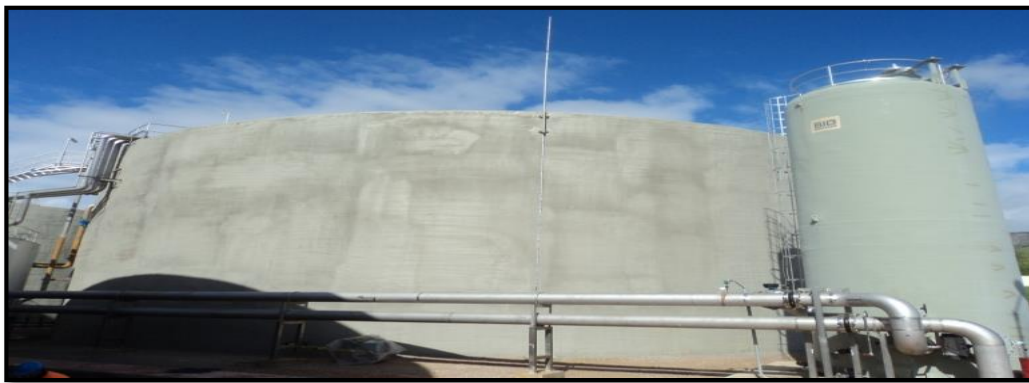
FIGURE 1.8 : DIGESTEUR STEP FES
