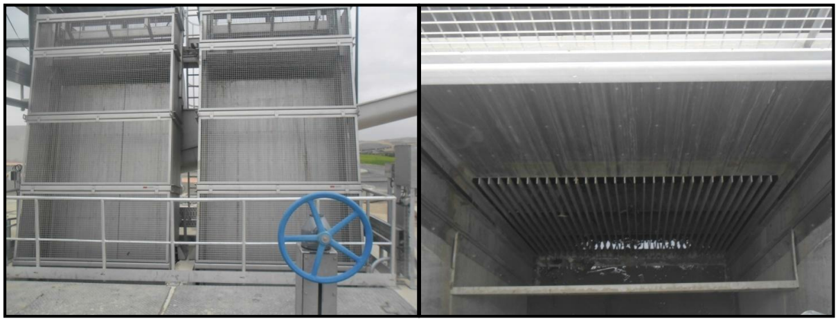
Figure 1.1 : Photo d'un dégrillage grossier
