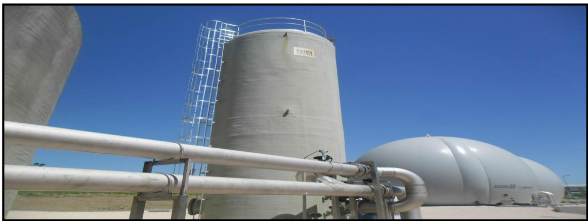
Figure 1.11 : Photo d'un désulfure de biogaz
