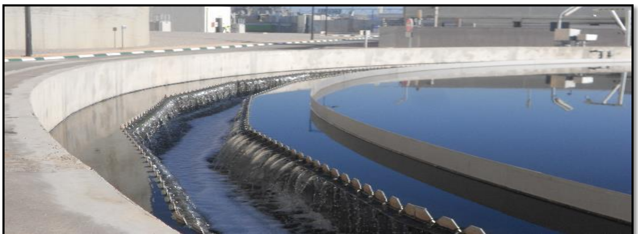
Figure 1.6 : Photos d'un clarificateur
