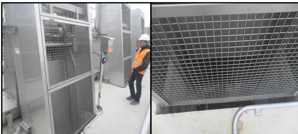
Figure 1.2 : Photo d'un dégrillage fin
