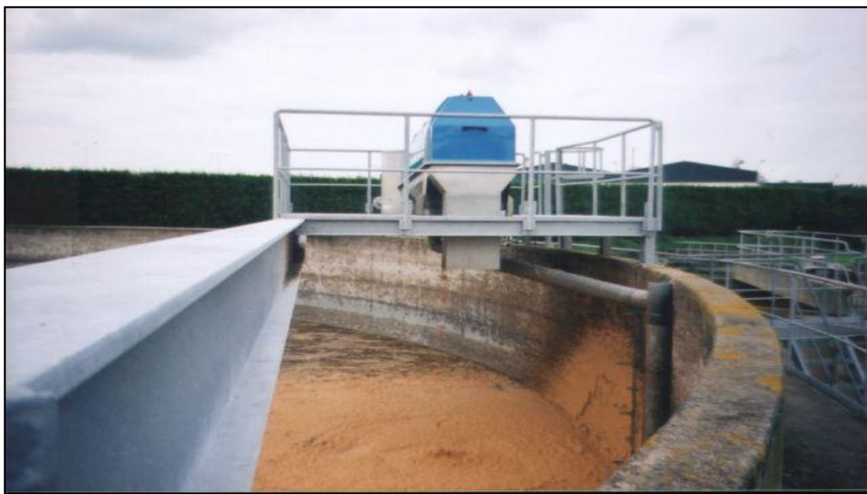
Figure 2: Épaississement des boues
