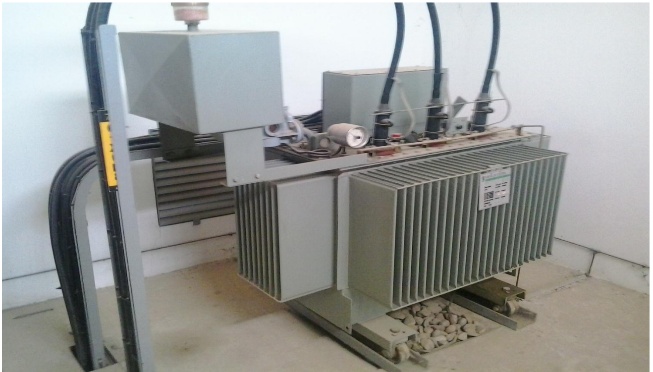
Figure 7:transformateur de la station
