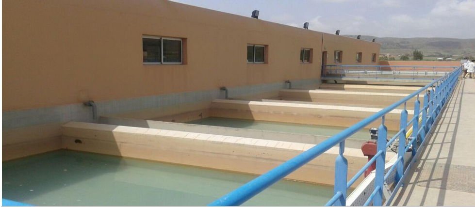
Figure 4 : Les filtres à sable
