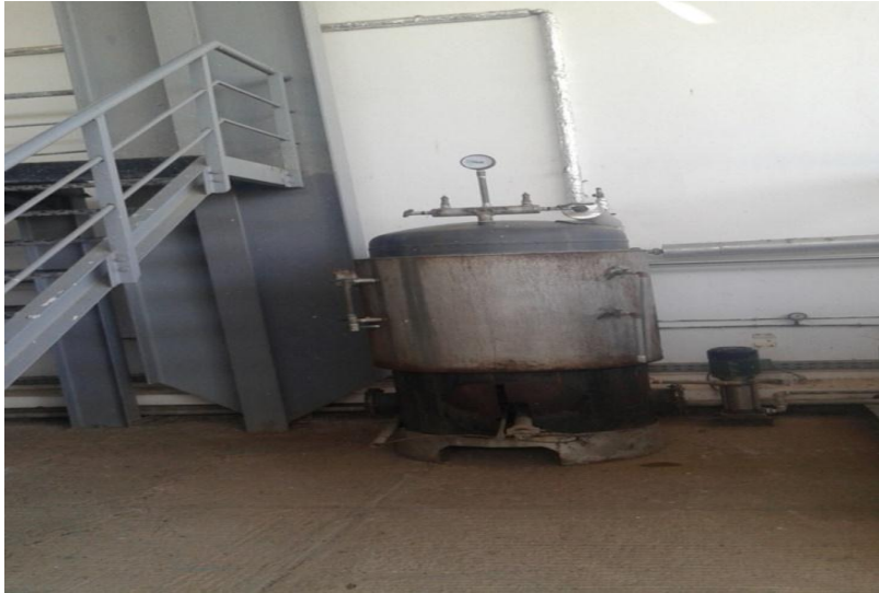
Figure 3: La chaudière( génératrice de vapeur d'ANPMA)
