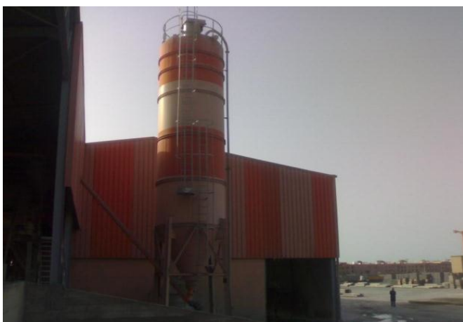
Figure 4 : Un silo de ciment
