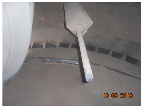
Figure 27 : Bouchage des buses d'une conduite d'injection d'eau
