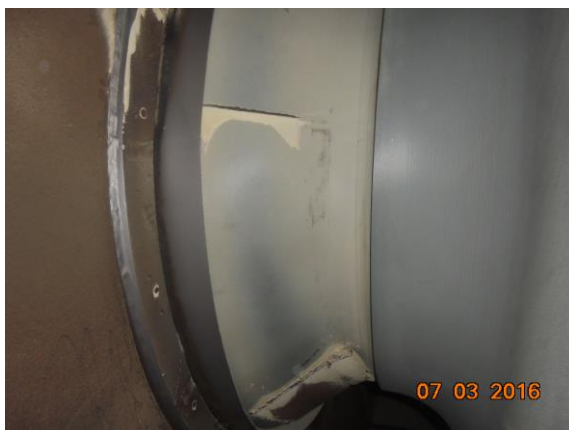
Figure 28 : Usure du ventilateur
