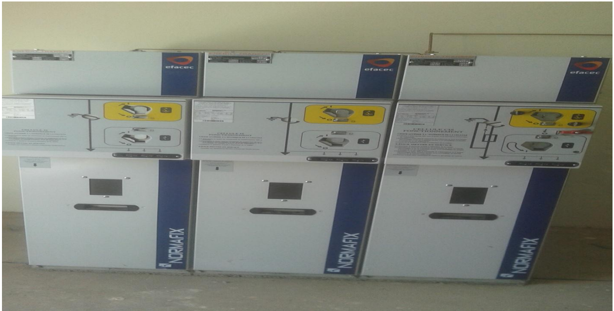
Figure 5 : Cellules de protection MT/BT
