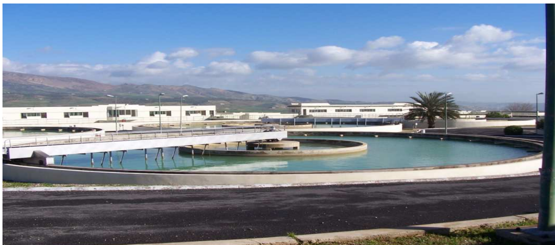
Figure 5 : Décanteurs à racleurs
