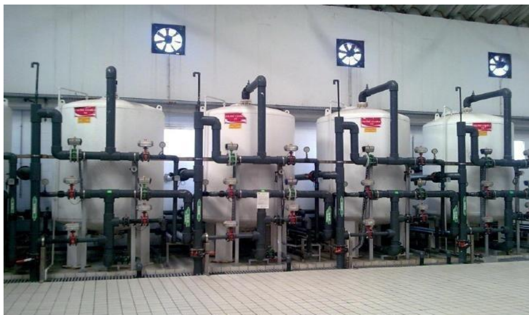
Photo 1 : Filtre à sable
