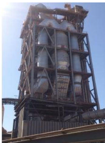
Figure 6 : Tours de préchauffage.
