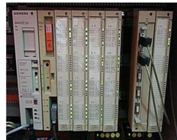
Figure 13 : API Siemens de la machine
