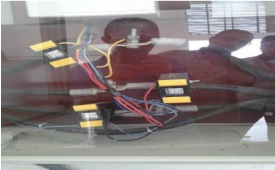
Figure6 :Transformateur de courant(TC)
