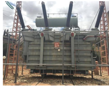
Fig20 : Transformateur N°2 poste EL OULALI
