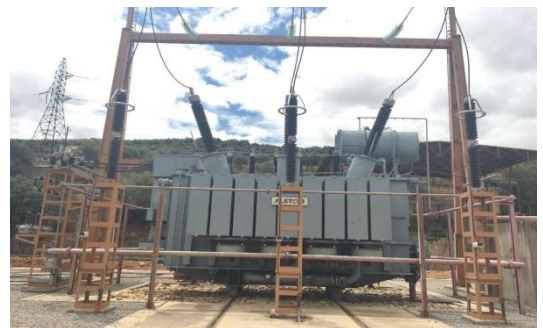
Figure18 : Transformateur N°1 a poste EL OULALI
