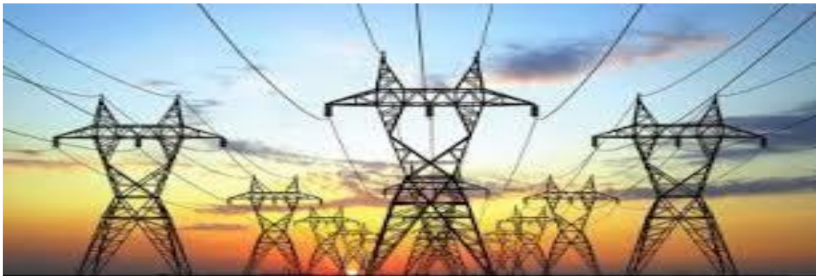
Figure4 : les lignes électriques
