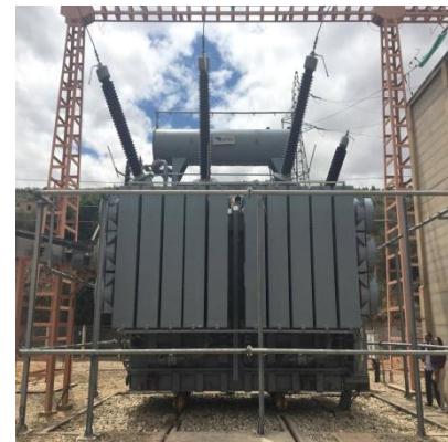
Fig22: Transformateur N°8 a poste EL OULALI
