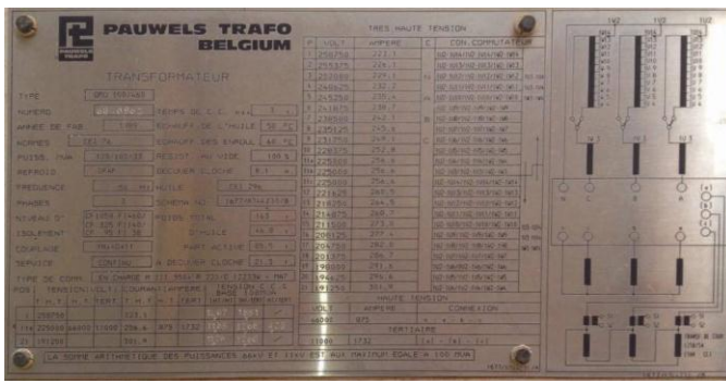
Fig21 : Plaque signalétique de transformateur N°2
