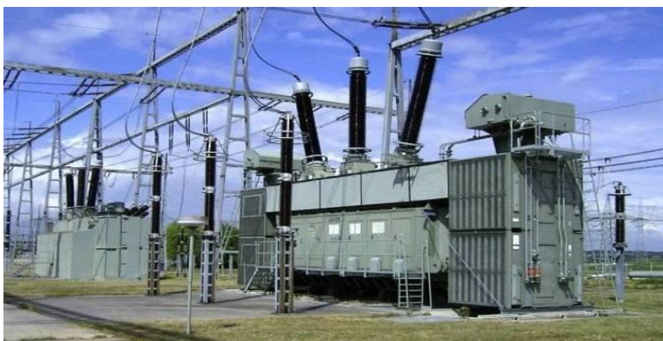
Figure6 : Transformateur de puissance
