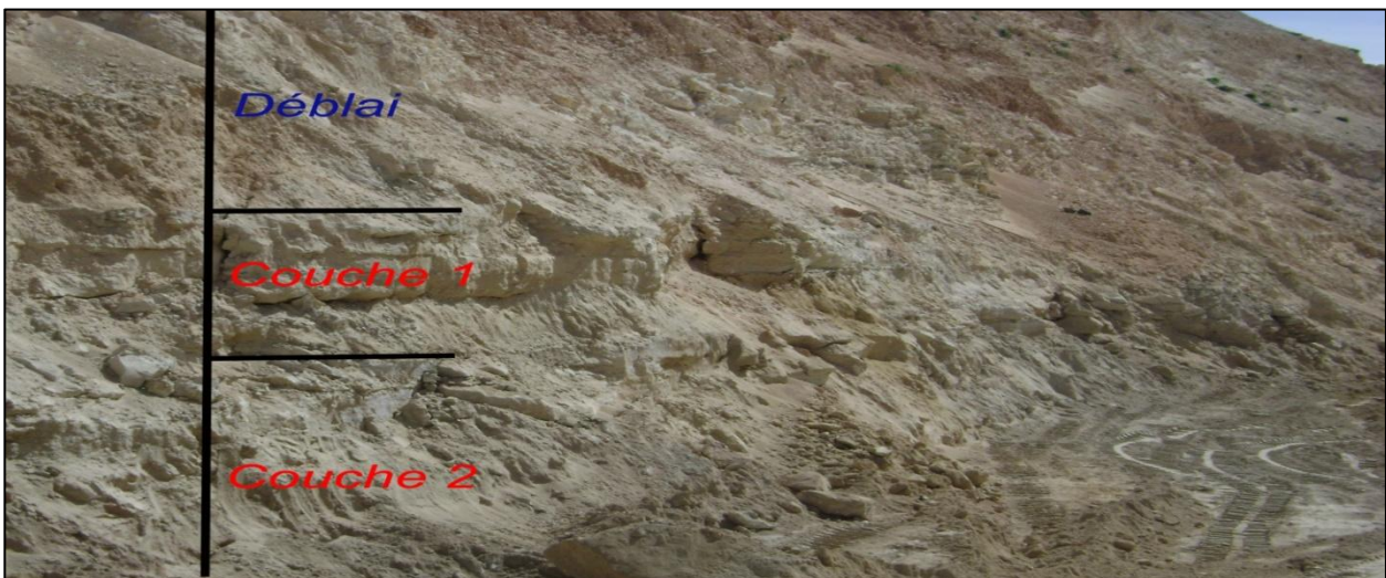
Photo 25 : Exemple 1 d'une mauvaise berme.
