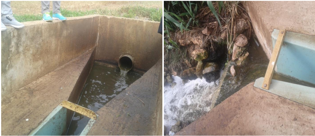
Image 9 : Rejet des eaux épurées
