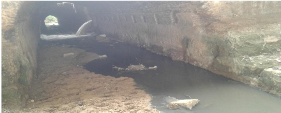
Image 10 : Rejet des eaux usées de la zone « Toulal »
