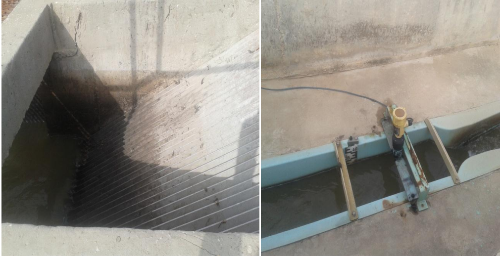
Image 6 : Ouvrage d'arrivé (Déssableur et mesure de débit)
