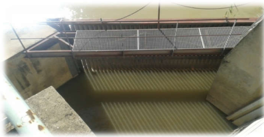
Figure 1: Opération de dégrillage dans la station de prétraitement
