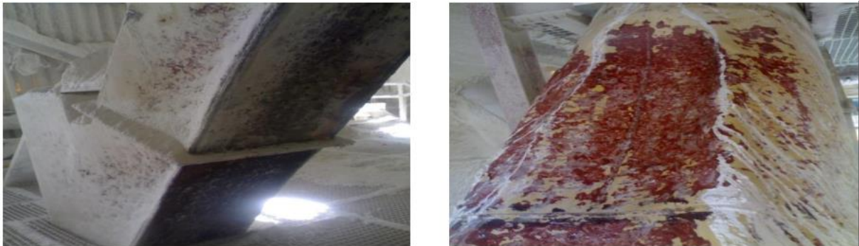
Figure 11 : Déformation et l'érosion du jeté T11-T01
